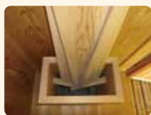
問題のトイレを上から見ると...
